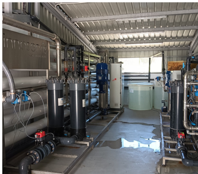
Planta de Ósmosis inversa para tratamiento interno de agua industrial
